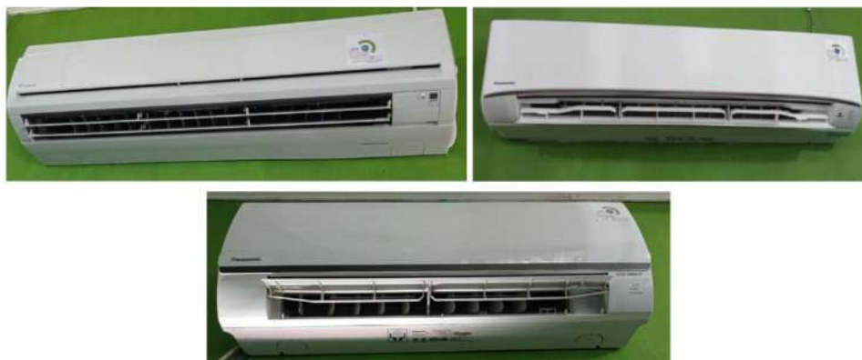
Gambar 3.2.5.1.1.5. AC Split wall mount ruang server/ pusat data daerah
