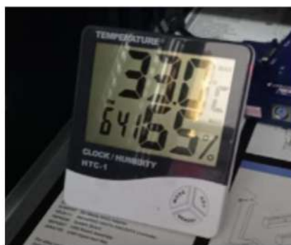
Gambar 3.2.5.1.1.6. Monitoring suhu dan kelembaban udara ruang server
