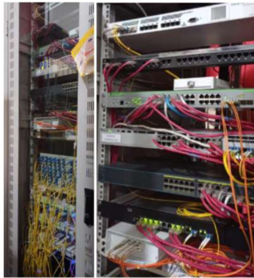
Gambar 3.2.5.1. . Manajemen kabel pada perangkat jaringan
